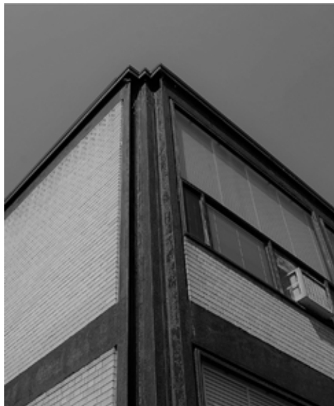
Figura 5: Detalle de esquina en fachada de la Hunstanton School (1949-54). Alison y Peter Smithson. Fuente: Anna Armstrong. Creative Commons. https://flic.kr/p/9sdwRV
